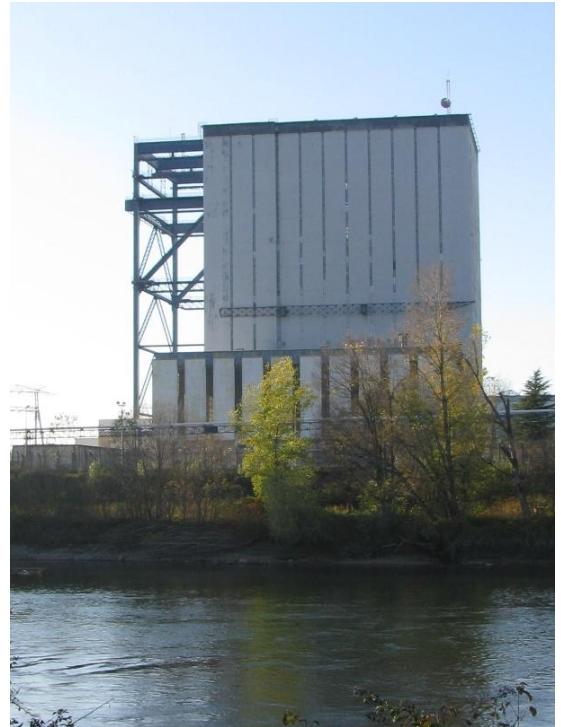
Centrale du Bugey (EDF - Département de l'Ain - France). Tranche N° 1 - Filière UNGG de 540 MW. En cours de démantèlement.
