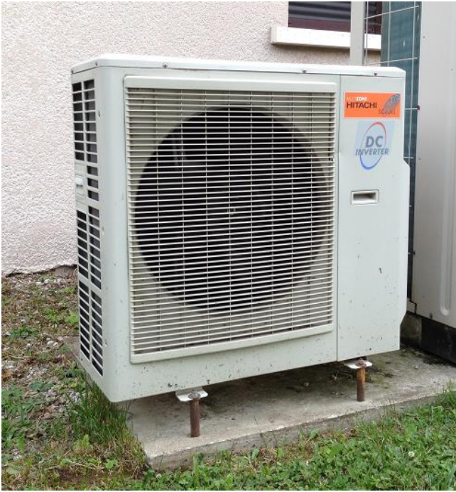
Groupe extérieur de climatisation et cassette intérieur de diffusion
